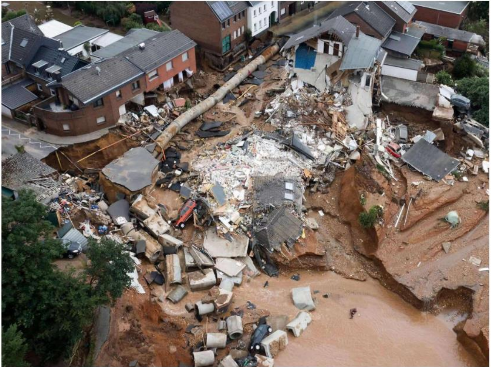
© Sebastien Bozon/AFP Das Unwetter hat Teile des Orts Blessem im Rhein-Erft-Kreis zerstört.
